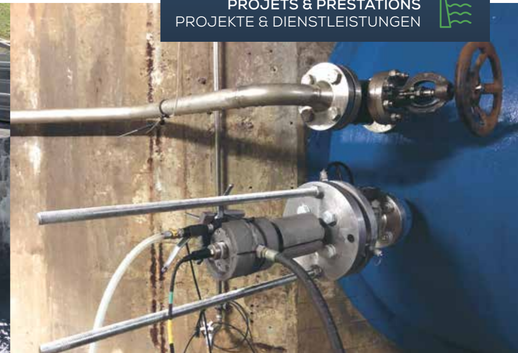
Sonde de soutirage dans le répartiteur d'un groupe Pelton. Entnahmesonde an einer Verteilung einer Pelton-Turbine.
