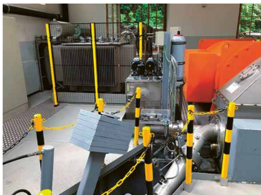
Voies de fuite, garde-corps et autres dispositifs sécuritaires ont été audités en 2021 sur l'ensemble des aménagements que nous gérons. A gauche, un exemple de marquage d'une voie de fuite, et à droite, de sécurisation d'un transformateur et d'une machine.
