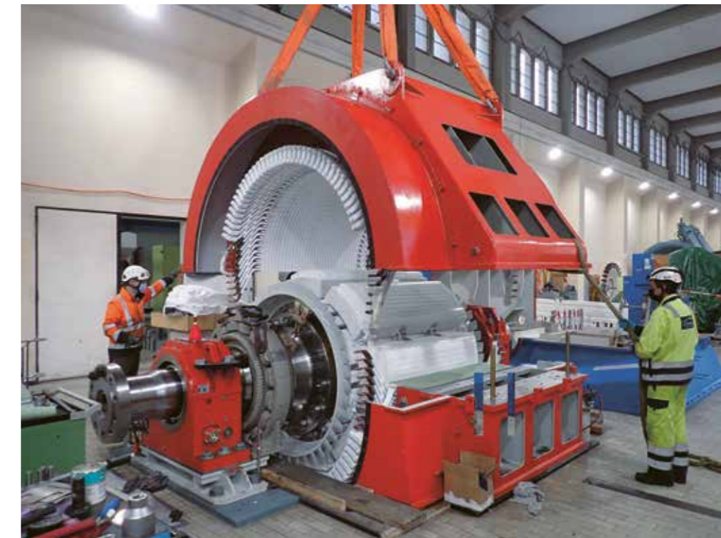
La réhabilitation de la centrale de Mottec, qui devrait permettre d'augmenter la production de 5 millions de kWh par année, prévoit le remplacement complet (vannes, turbines, alternateurs et transformateurs) de 2 des 3 groupes.
